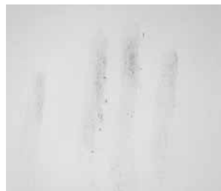
Trace de doigts sur revêtement
